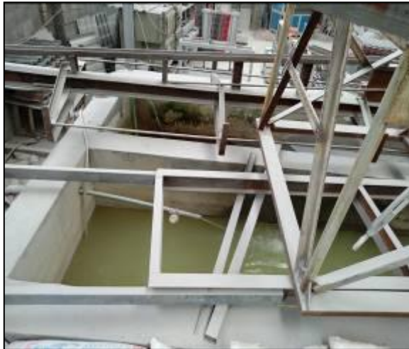
冷却水循环水池
