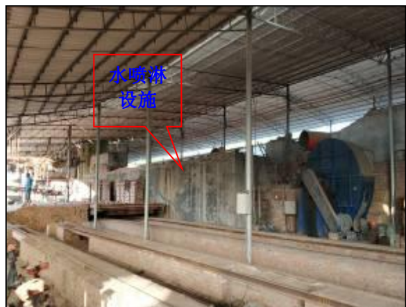
烘干烧结烟气水喷淋除尘设施
