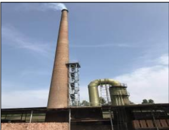
采样平台及脱硫塔
